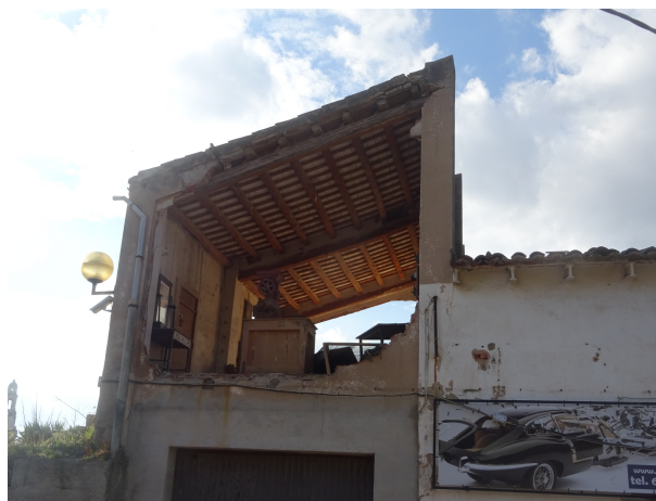
Figura 4. Fotografía del segundo piso de un taller de coches en Valls cuyas paredes laterales fueron arrancadas durante el tornado. Una de las paredes cayó sobre un vehículo estacionado en la calle (autor: Oriol Rodriguez, Universitat de Barcelona).
