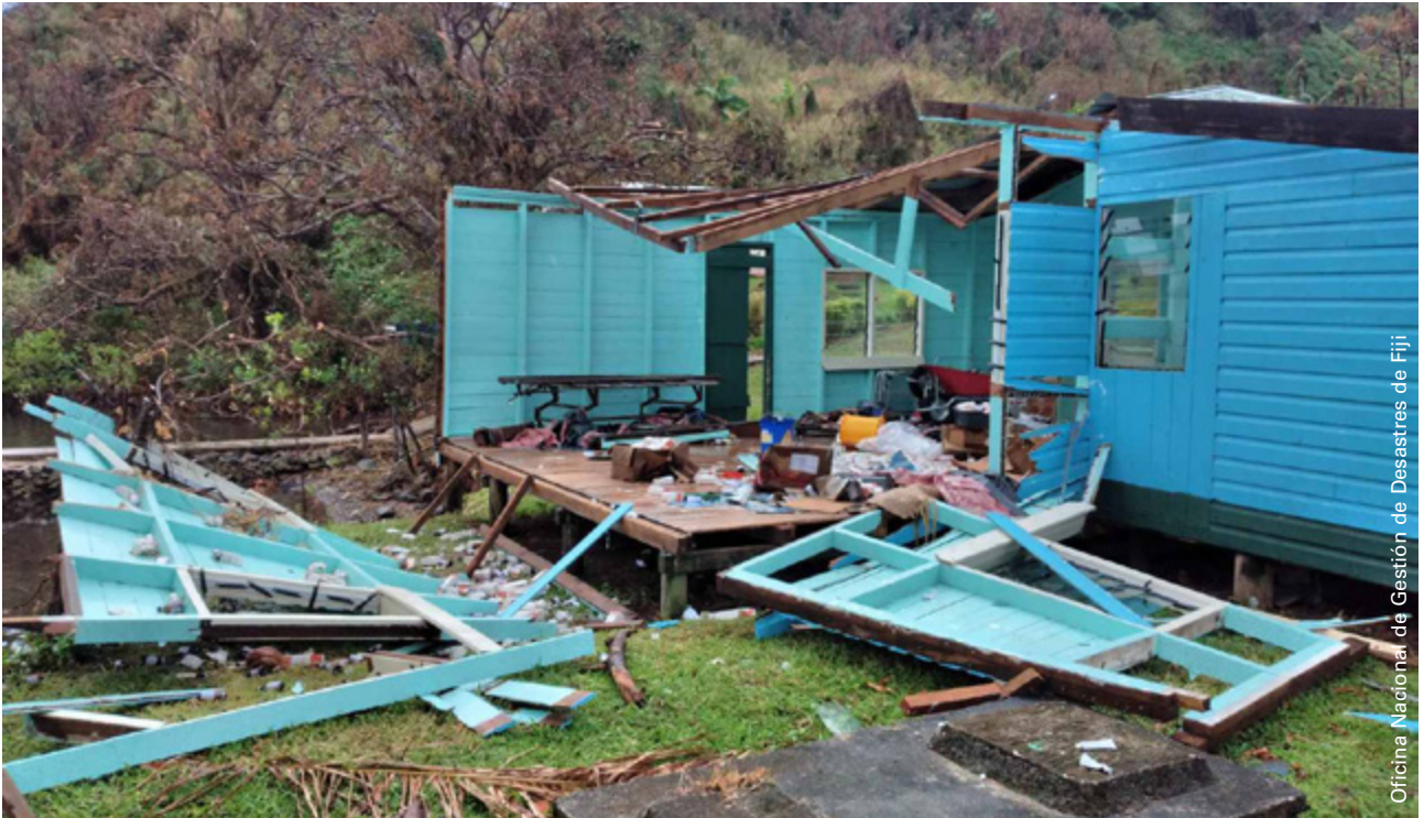
El ciclón tropical Harold causó daños generalizados en Fiji.
