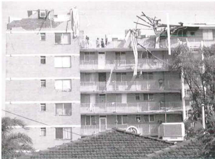
Figura 3 — Daños causados por un tornado de temporada fría en Perth (1999)
