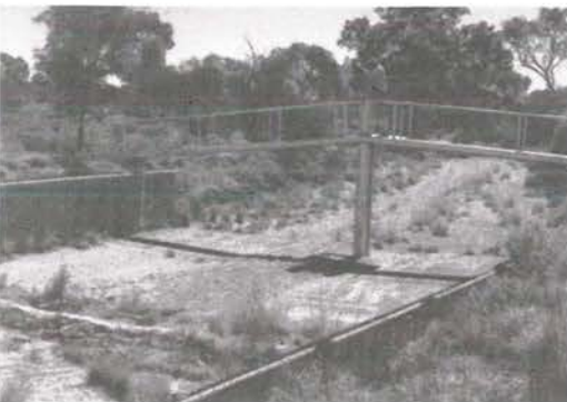
Sección de control y medida de la corriente
