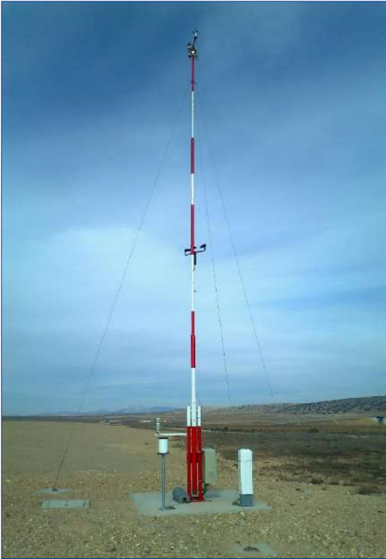
Estación Meteorológica Automática
