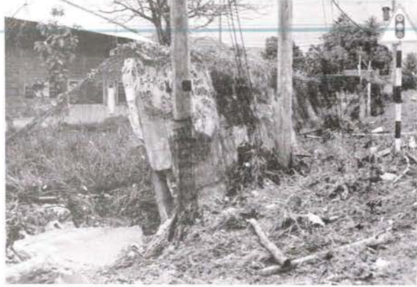
Trinidad - Un muro socavado por la intensa lluvia en julio de 1984. (Fotografía: K. Maharaj)
