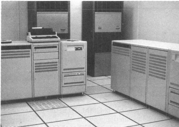
Dos unidades DEC VAX 11/750 instaladas en el Centro Meteorológico Regional de Buenos Aires.
