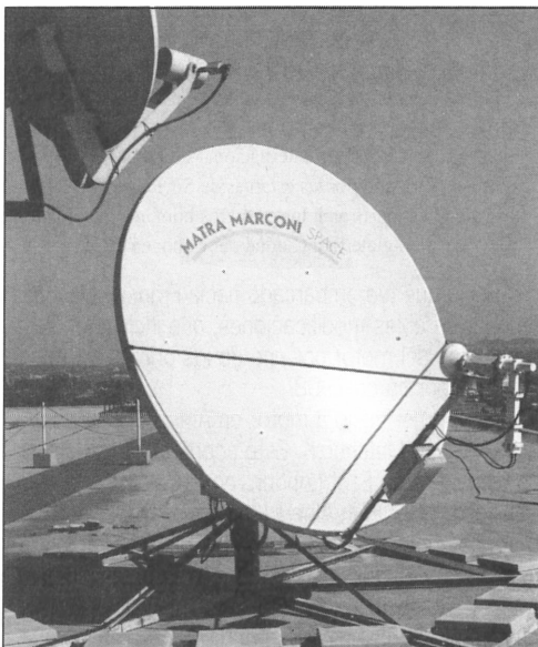
Antena del SADIS en la azotea del Edificio Forum de Pretoria, Sudáfrica. Recibe y transmite datos al Servicio Fijo Aeronáutico
