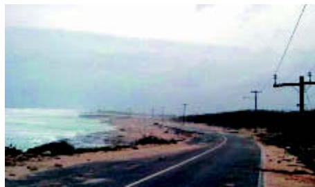
Erosión por olas en una carretera costera
