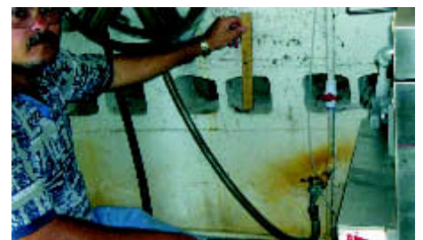
Una ola de un metro rompió esta habitación de un generador de hidrógeno (elevación de 1,8 m)
