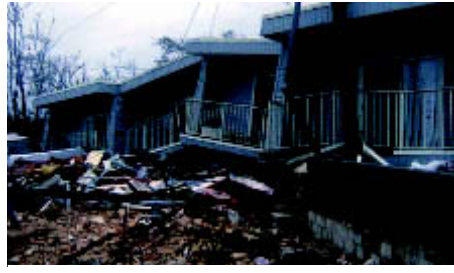
Derrumbe total de un complejo de apartamentos
