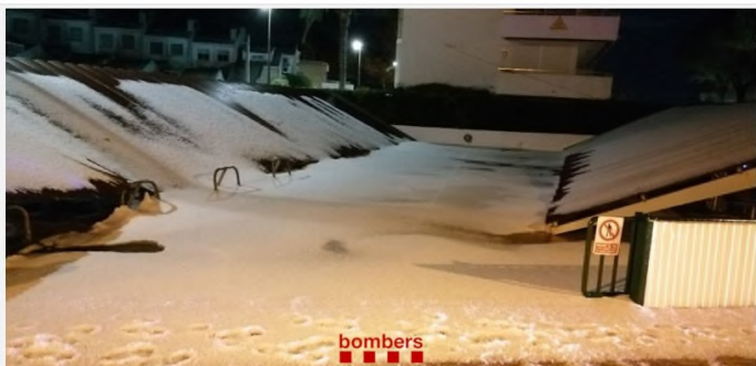
La marquesina d'un aparcament privat no ha suportat el pes de la pedregada i ha cedit. Foto: ACN/Bombers
